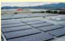
三重伊勢工場の設置事例
