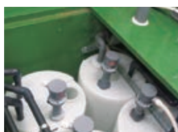
酸・アルカリ廃液タンク
