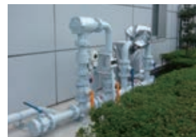
新設したガス配管
