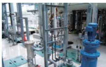
排水処理場 （滋賀野洲工場）
