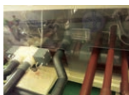
廃液移送配管
