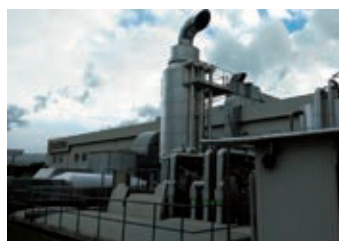
排気処理装置
