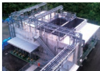
排水処理設備
