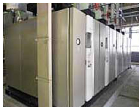
新たに導入したボイラー
