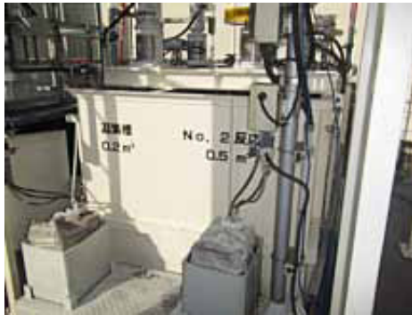
研削廃液処理設備
