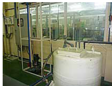
排水リサイクル設備
